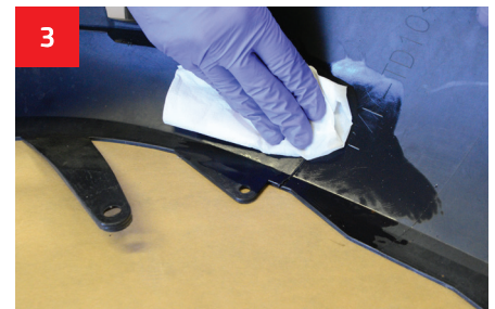
3 Reinigung und Entfettung der Reparaturstelle mit WK900 an beiden Seiten der Beschädigung.
