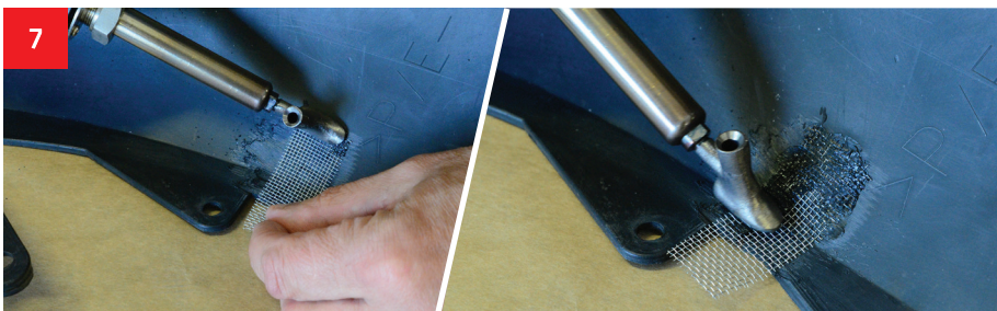
7 Mit dem Schweißgerät wird das Netz punktuell an der Außenseite der Beschädigung angeschweißt.
