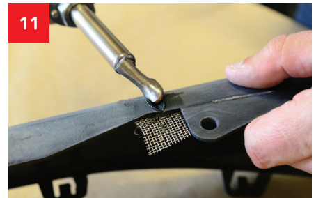
An der Außenseite der Beschädigung eine Stelle für das Einschweißen des Bindemittels vorbereiten.
