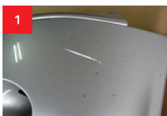
1 Examiner le dommage.
