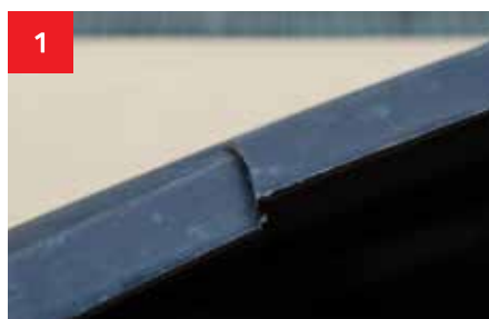
Oględziny uszkodzenia i dobór technologii naprawy.
